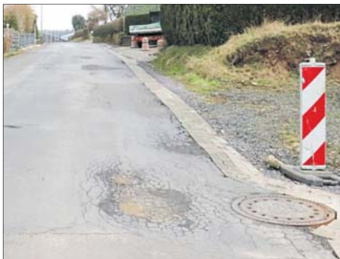
Die Obere Hauptstraße im Ortsteil Weidenau weist nicht nur auf der Fahrbahn Schäden auf.
